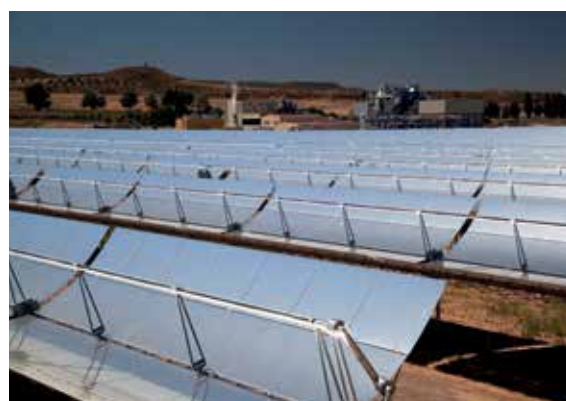
Planta termosolar de Les Borges Blanques (Lleida). Solar thermal power plant in Les Borges Blanques (Lleida).
