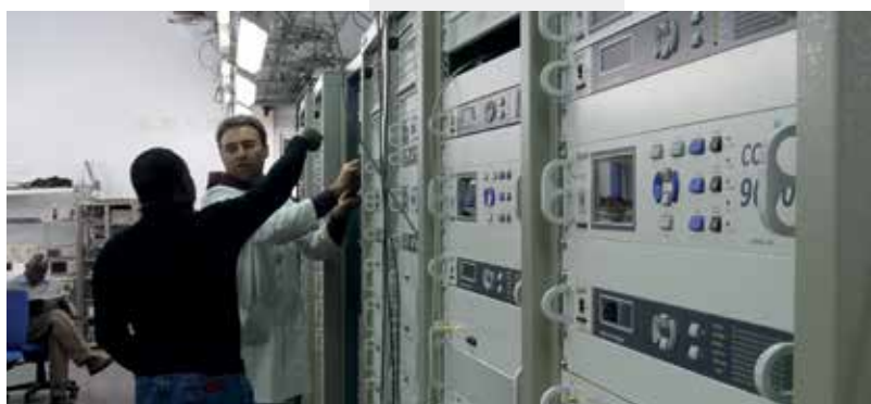
Pruebas de aceptación de transmisores de TV Digital 2,3KW (Kenia). Acceptance tests of 2,3 KW Digital TV transmitters (Kenya).
