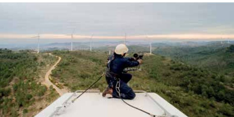
Operación y mantenimiento de parques eólicos. Operation and maintenance of wind farms.
