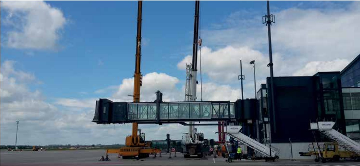
Suministro de pasarelas de embarque para el Aeropuerto de Gdansk. Polonia Supply of boarding bridges for Gdansk Airport. Poland
