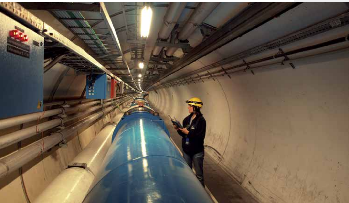
Instalaciones en las sedes del CERN en Preessin y Meyrin. Francia y Suiza. Installations at CERN facilities at Preessin and Meyrin. France and Switzerland.
