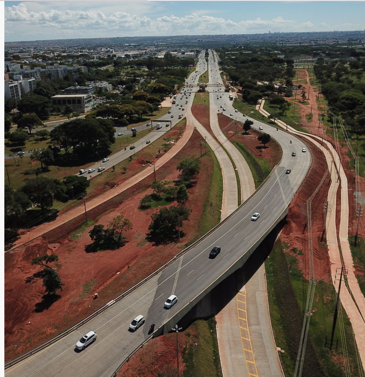
Obras del BRT realizadas en uno de los principales ejes de movilidad de la zona, Brasilia (Brasil). ▶
