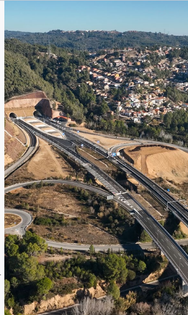
Construcción en la B-40 entre Olesa de Montserrat y Viladecavalls, Barcelona (España). ▶
