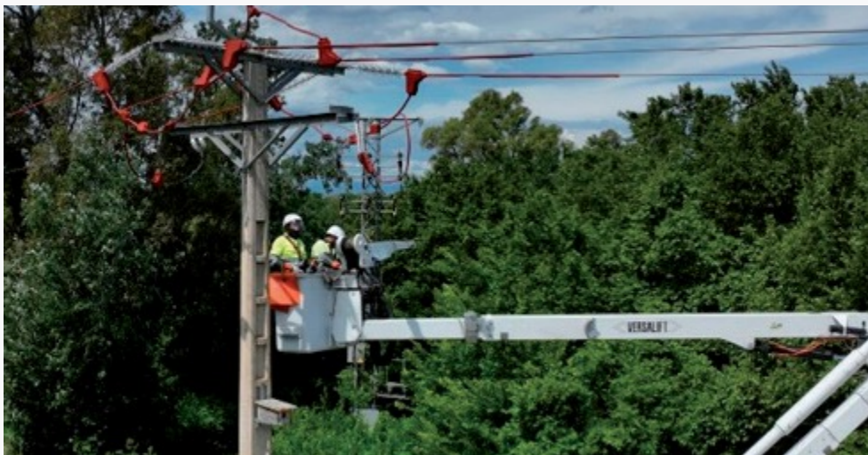
▲ Intervenciones en torres de alta tensión de diferentes localizaciones para reducir la afectación a la avifauna de estas infraestructuras.
