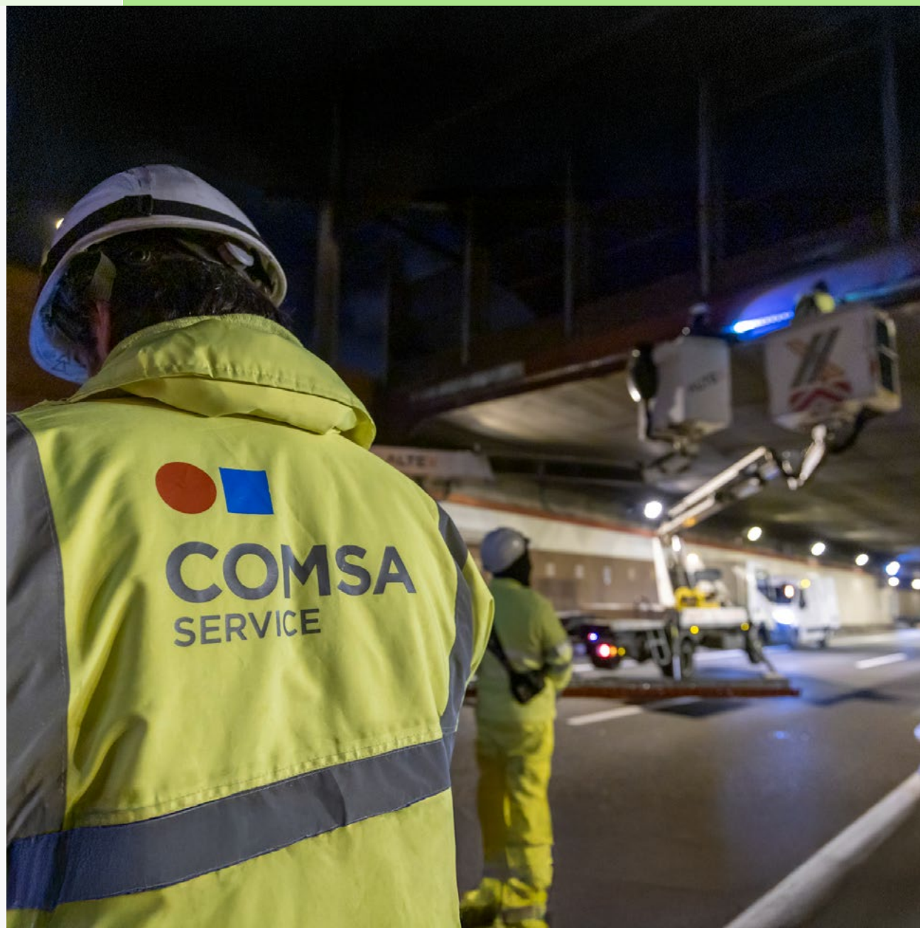
Operarios de COMSA Service en los trabajos de mantenimiento de las rondas, Barcelona (España).
