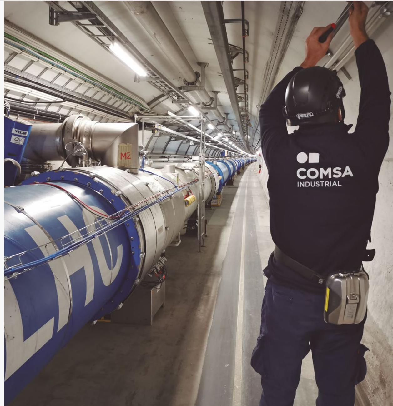
COMSA Industrial realiza trabajos de renovación de las instalaciones eléctricas y soporte de redes y telecomunicaciones en las sedes del CERN, Preessin y Meyrin (Francia y Suiza).
