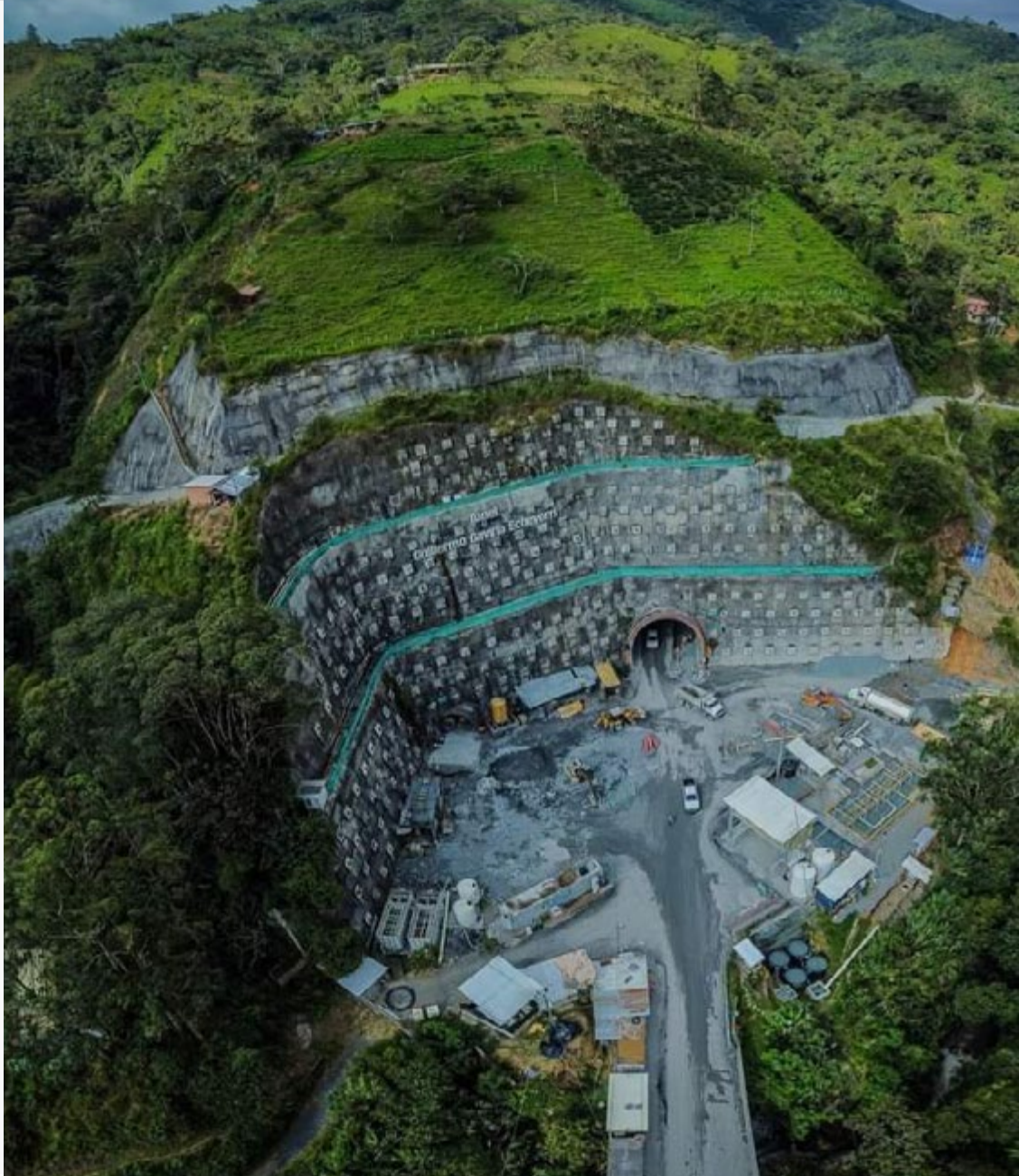
Equipos electromecánicos, de control y de radiocomunicaciones del proyecto Túnel ► Guillermo Gaviria Echeverri (Túnel del Toyo) y sus vías de acceso (Colombia).
