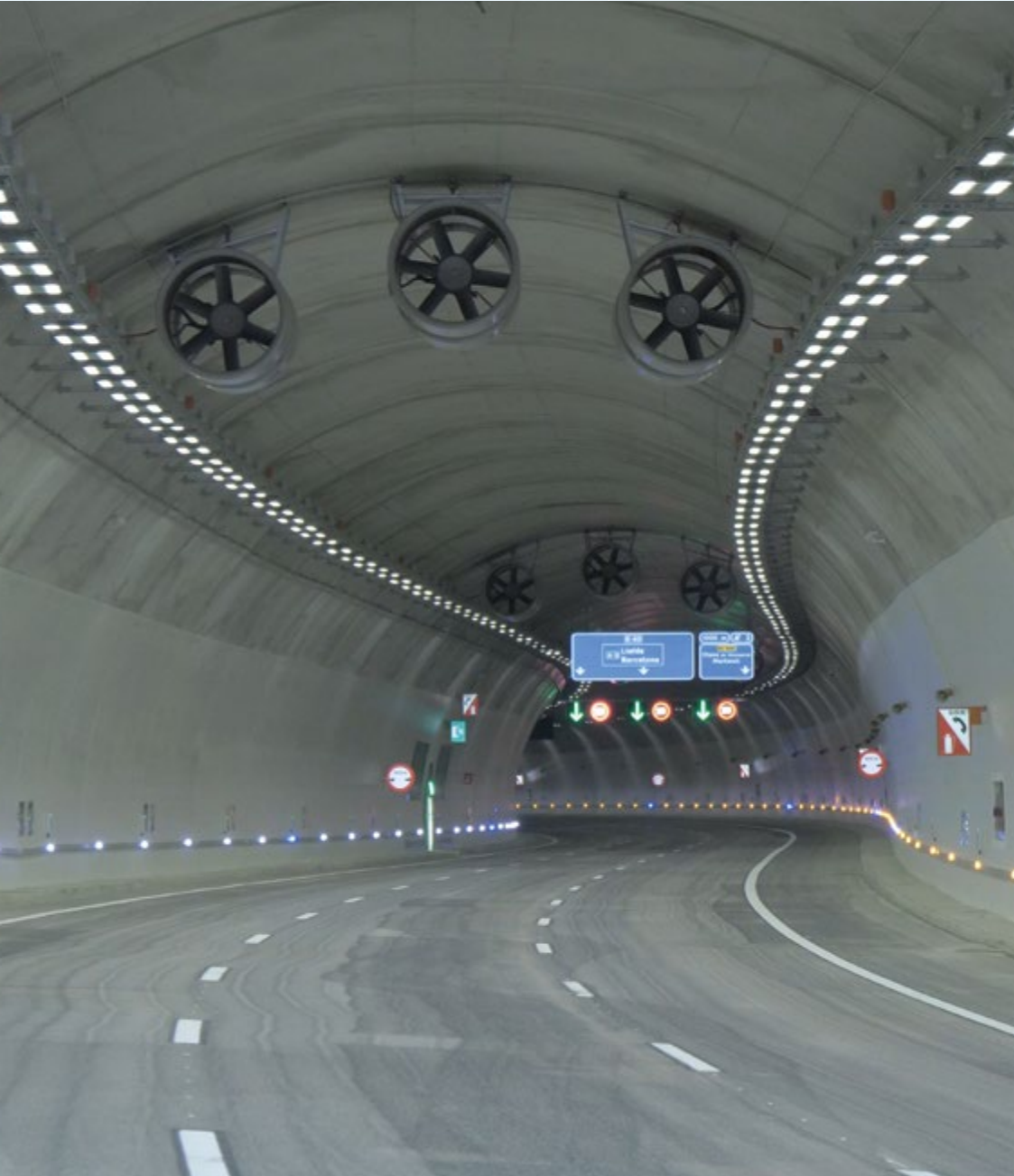
Instalaciones para el túnel de la B-40, en Barcelona (España). ►
