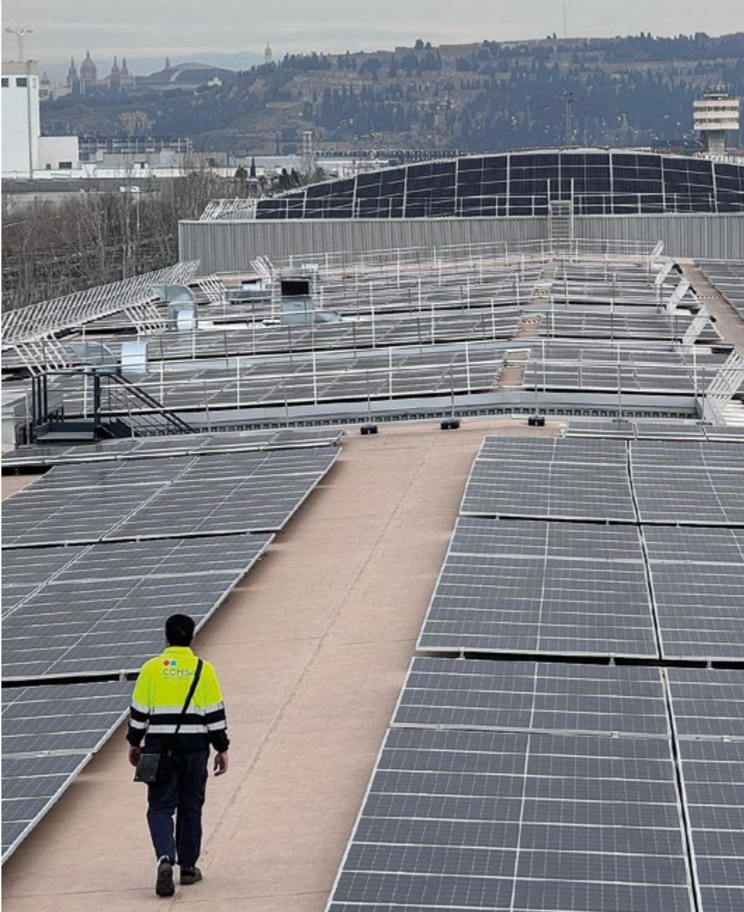
Planta fotovoltaica en la cubierta de los talleres de L9/10 de Metro ▶ de Barcelona (España).
