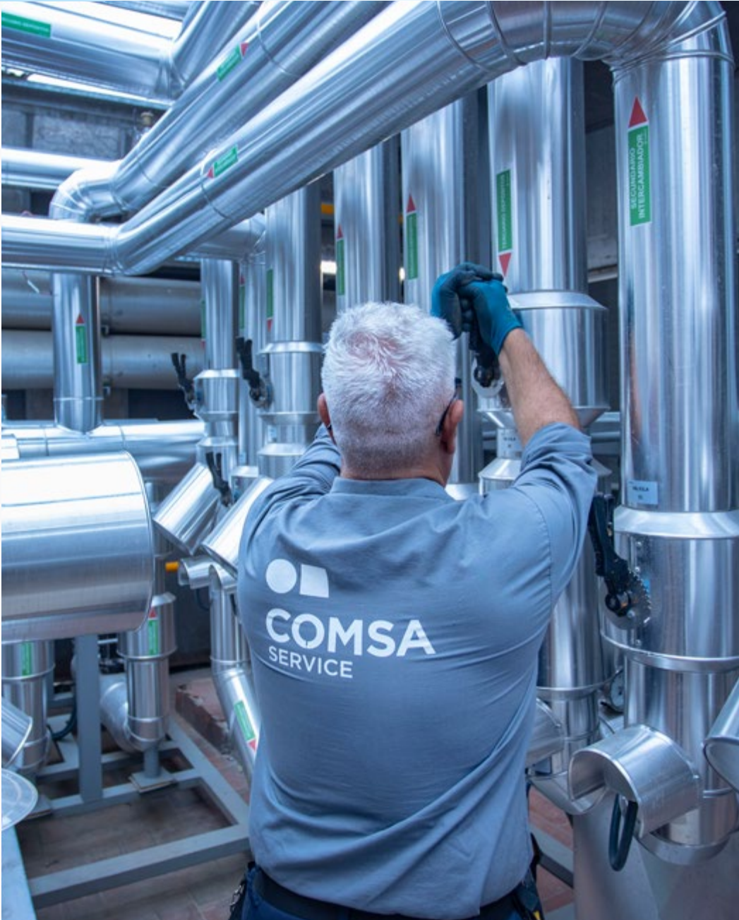
Mantenimiento multitécnico del Consorci Mar Parc de Salut de Barcelona (España). ►
