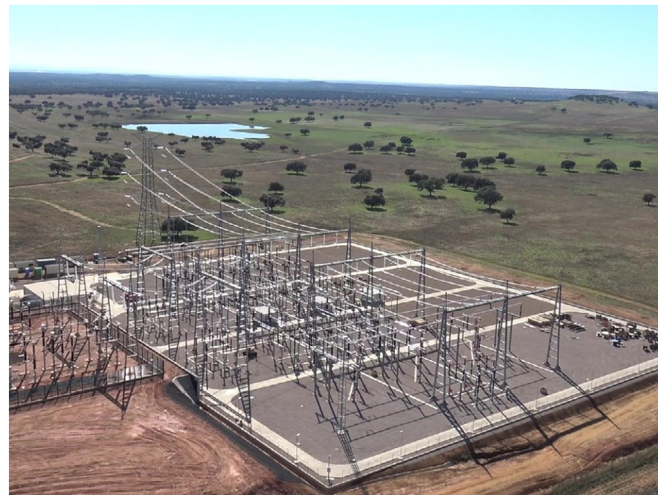
Subestación de Carmonita, Badajoz (España)
